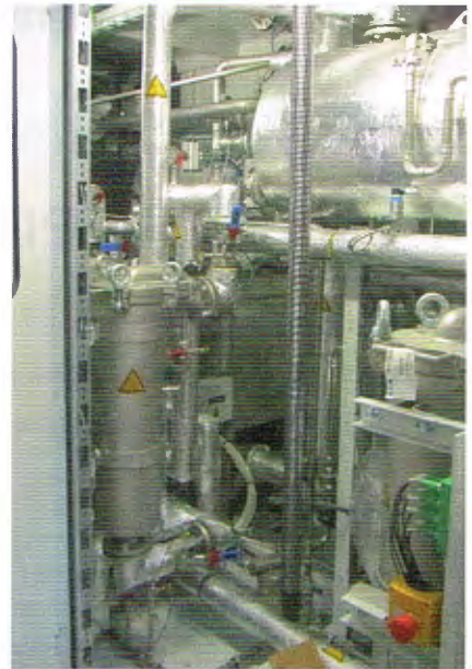
Die Filtration des Lösemittels erfolgt im Zu- und Rücklauf durch Doppelfilter, die einen Filterwechsel im laufenden Betrieb ermöglichen
